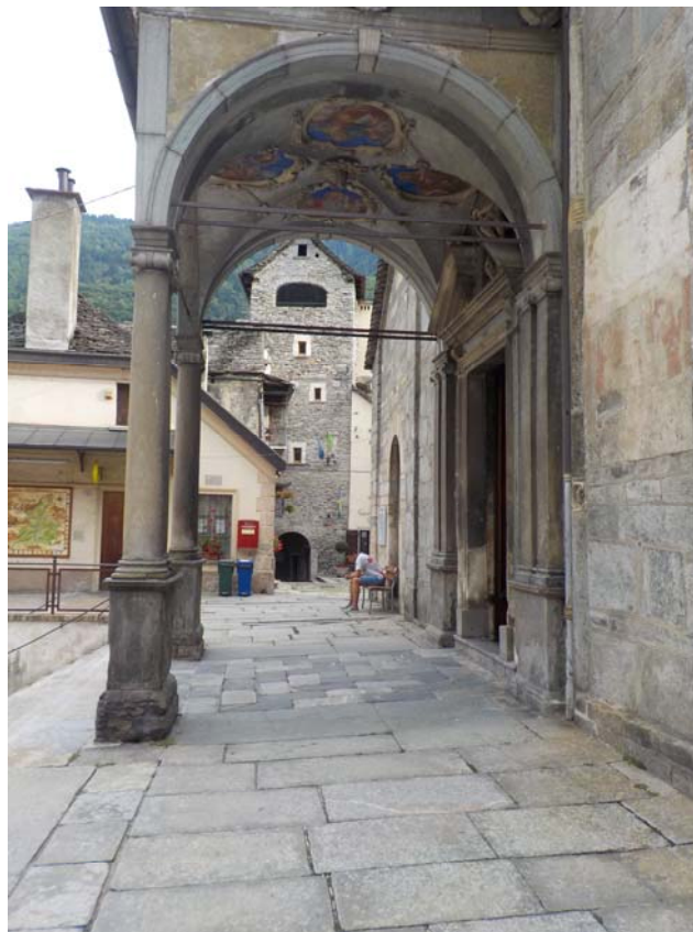
Le porche d'entrée, de facture naturellement plus récente que les murs de la bâtisse.
